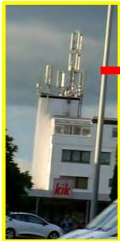
Mobilfunk- sendeanlage Nr. 240217
