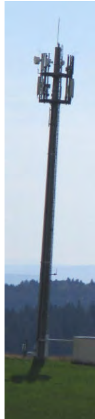
Mobilfunksender mit 37 Sektorantennen und TETRA
