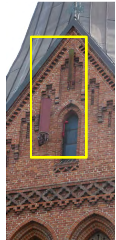
Ausschnitt von Nordseite des Kirchturmes mit rot gestrichenen Antennen. Laut Standortbescheinigung strahlen achtzehn 330°-Antennen in den Kurpark.
