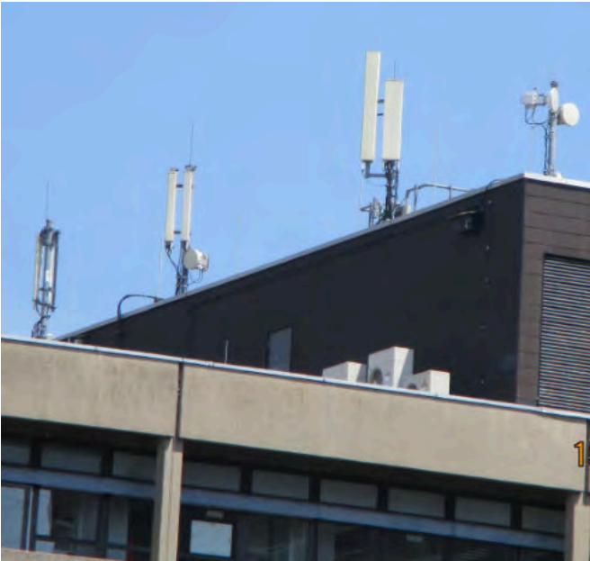
Mobilfunksendeanlage auf den Chemischen Instituten, Standortbescheinigung 23.12.19: Höhe 31 m, 9 Sektorantennen
