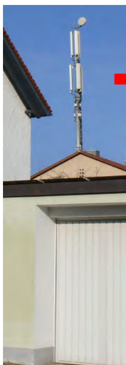
Mobilfunk- sendeanlage Nr. 671234
