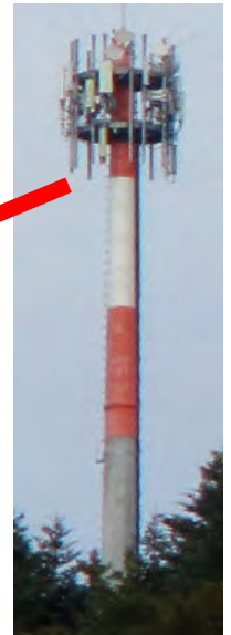
12.10.21 Mobilfunk- sendeanlage und BOS- Digitalfunk oberhalb von St. Blasien
